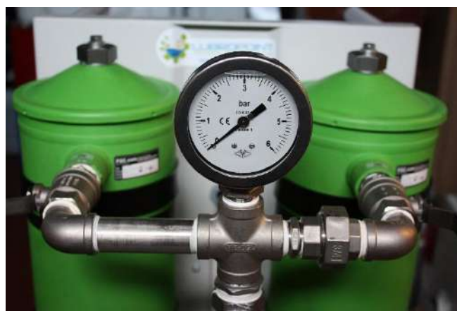
Trattamento di oli per compressori frigoriferi (necessario acciaio SS per la presenza di ammoniaca)
